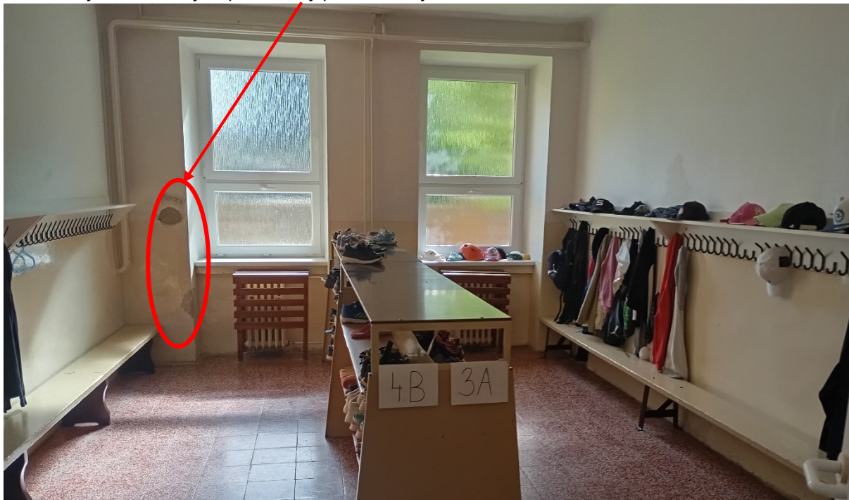
Foto č.2 vybavení šatny 2; poškozený povrch stěny
