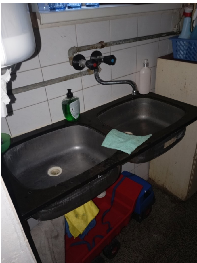
Foto č.9 výtok s teplou vodou nad dvojdfrezem v dílně školníka
