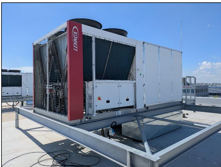
Obr. 2 Pohled na měřenou jednotku rooftop Lennox EVIO – zadní strana
