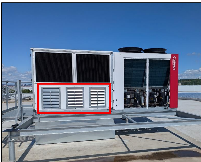
Obr. 2 Umístění větracích žaluzií
